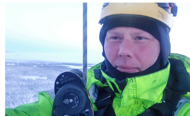
Reparation av vindkraftverkens vingar kräver arbete på hög höjd. Med Greger Nilssons patenterade system kan Blade Solutions reparera vingarnas avisningsystem året runt.
